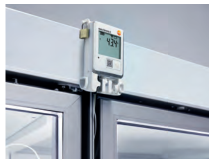
Sledování chladničky s ultra hlubokým chlazením v laboratoři (testo Saveris 2-T3 s teplotní sondou).
